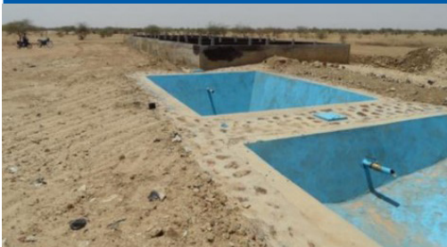
Bassin de lagunage de la station de traitement
